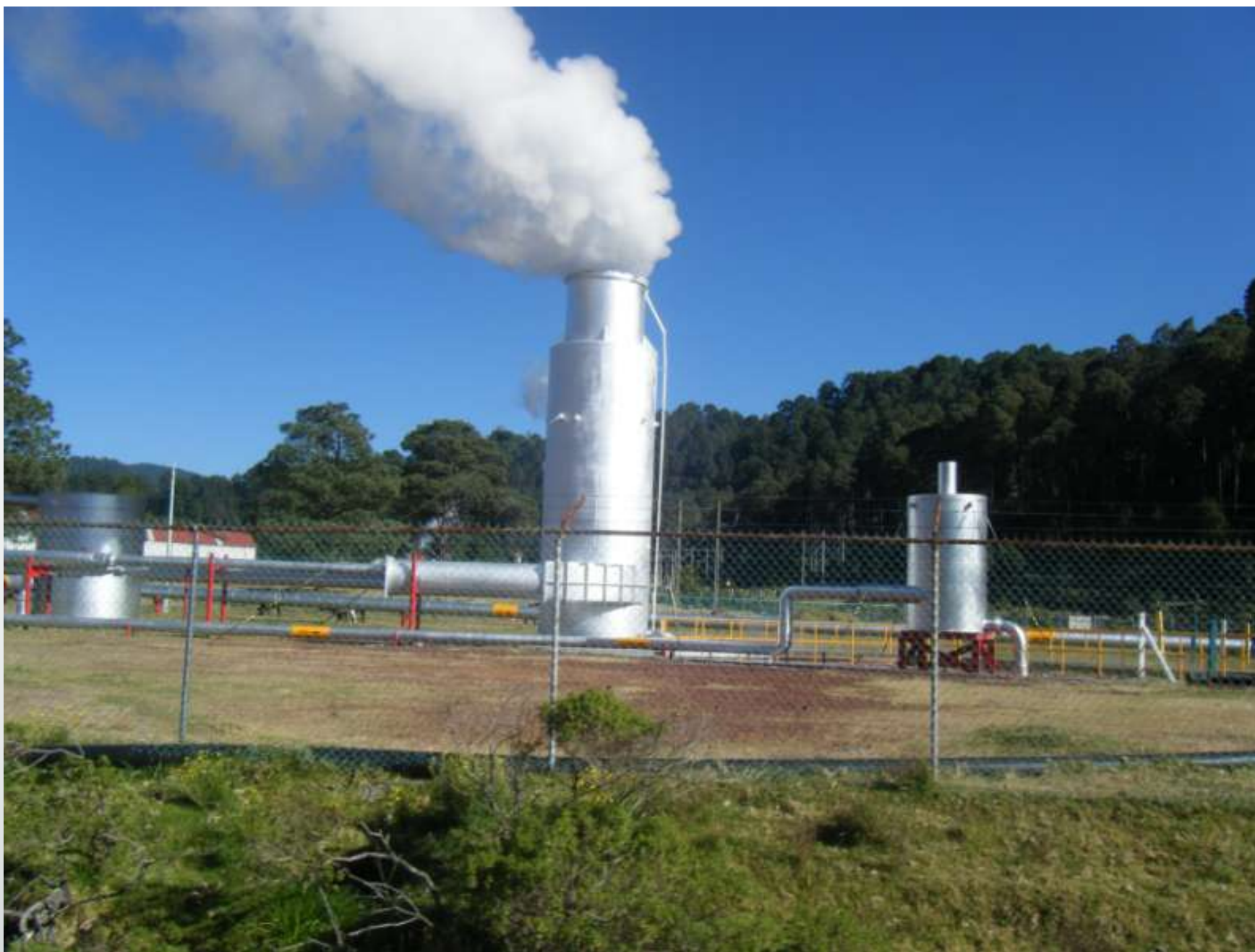
Central de Energía Termoeléctrica
