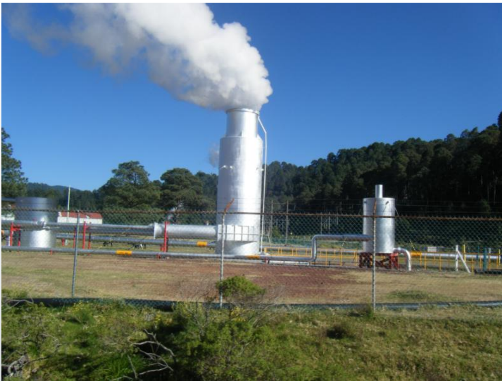
Central de Energía Termoeléctrica
